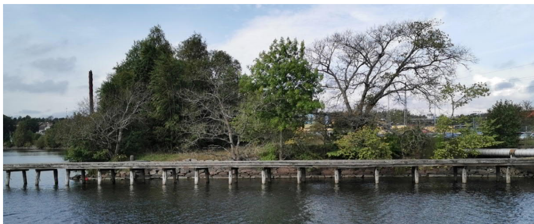
Bild 5 - Erosionskydd av stenmur vid utmynning av Gamla Hamnkanalen
